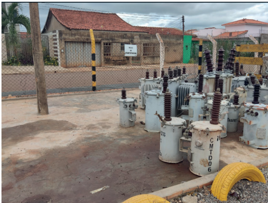
Figura 8 - Bacia de contenção
